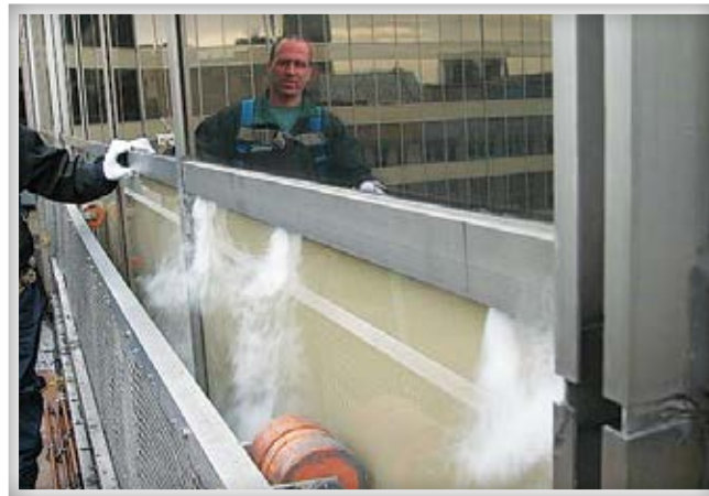
Figure 15 : Exfiltration excessive de fumée par les chantepleures d'un mur-rideau.
