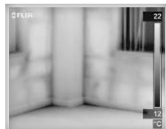
Figure 5 : Perte de chaleur par convection notée sous les fenêtres (bâtiment en pression négative).
