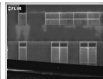
Figure 7 : Humidité notée sous les fenêtres d'un assemblage de mur extérieur en maçonnerie (bâtiment en pression positive).
