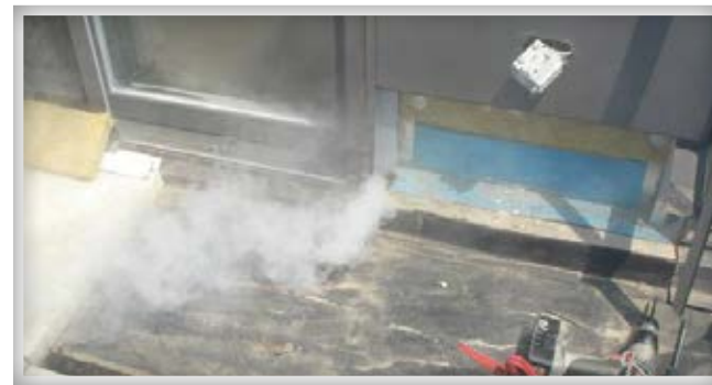
Figure 14 : Exfiltration excessive de fumée sous un assemblage de mur.
