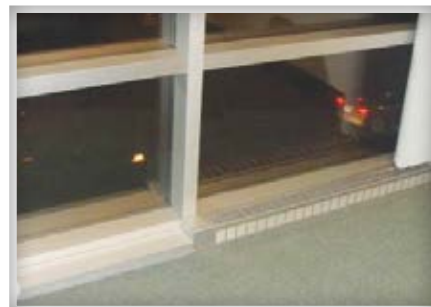
Figure 3 : Une source de chaleur intérieure située directement contre la face intérieure du mur-rideau entraîne des résultats trompeurs.
