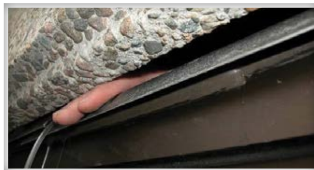
Figure 13 : Le démantèlement d'une finition intérieure à la tête d'une fenêtre révèle une trajectoire directe d'infiltration d'air.
