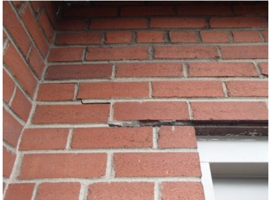
Corrosion des linteaux d'acier
