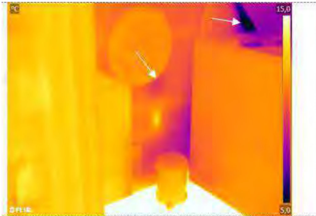
15 : Infiltration d'air froid près du conduit de sècheuse et de façon plus diffuse en partie courante du mur.
